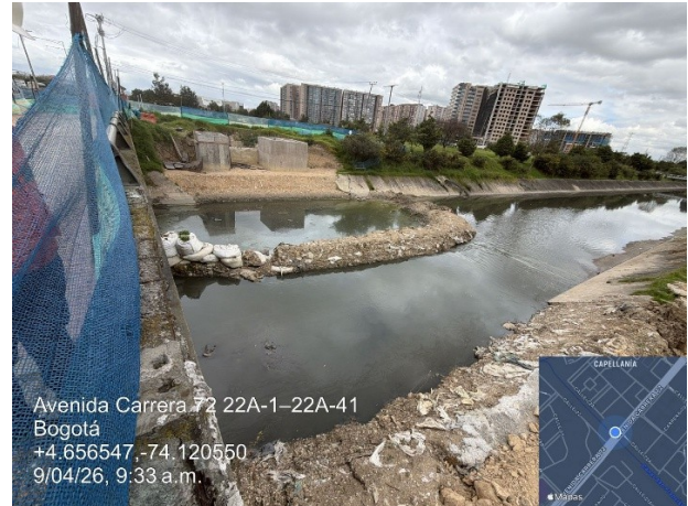
Fotografía No. 10. Vista frontal cauce canal san Francisco, lozas costado norte a renovar y desvío temporal con bolsacreto en mal estado.
