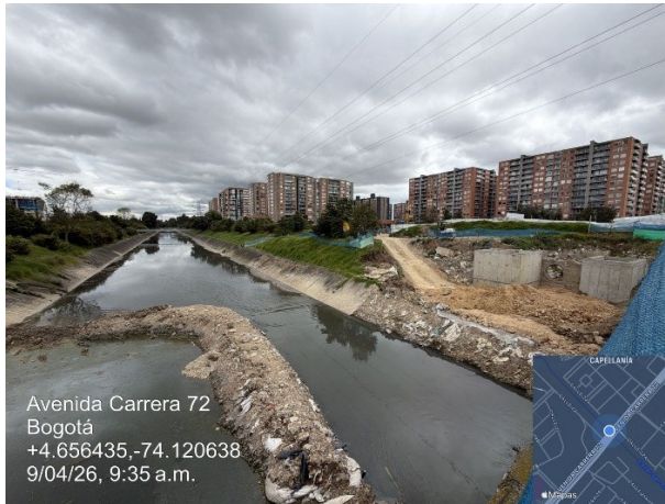
Fotografía No. 9. Vista frontal cauce canal san Francisco, lozas y cajas de inspección costado norte a renovar y desvío temporal con bolsacreto en mal estado.
